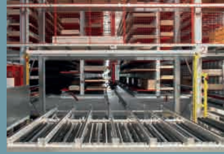
Station de transfert depuis l'entrée marchandises vers l'entrepôt automatisé
